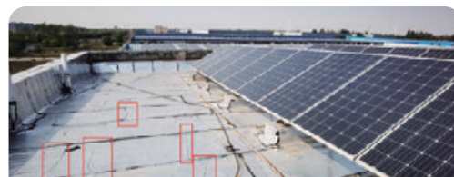
卷材老化开裂+设备打孔安装→防水层失效
