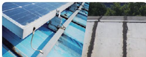
耐久性差 有渗漏隐患 维修难度大 安全系数低
