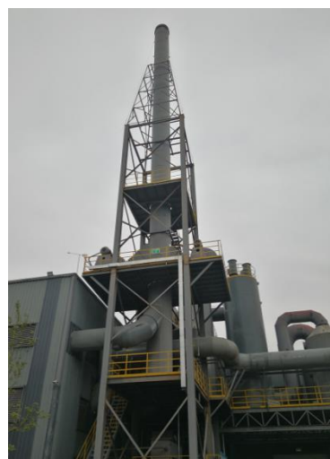
图 3.1.2-13 改性沥青防水卷材废气处理装置及排气筒
